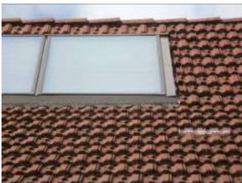
Gut: farblich gut angepasste eingebaute Anlage
