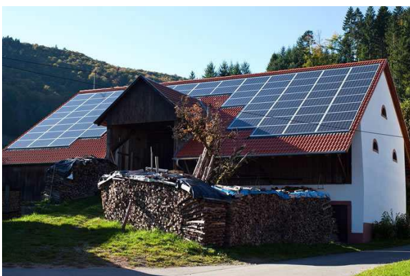
Schlecht: nicht an die Dachform angepasste Kollektorfelder
